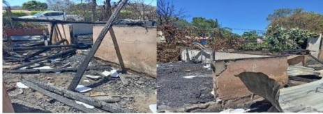
Figura 2. Fotografías tomadas el 28 de febrero de 2024. Muestra vestigios de una vivienda siniestrada en incendio estructural. Sitio Portegolpe. Distrito Tempate.
