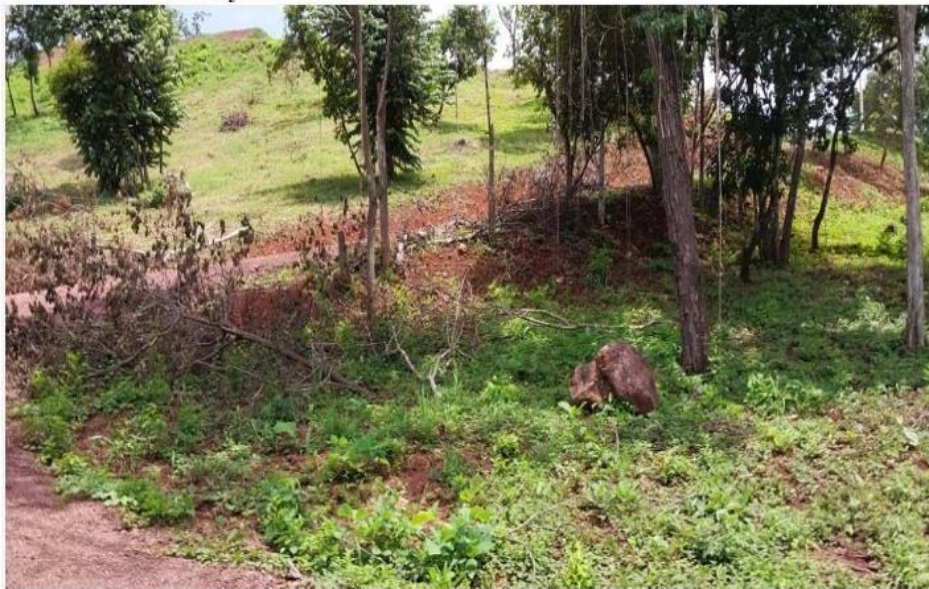
Fotografía 1. Tomada el 12 de octubre del 2023. Muestra atención a denuncia SITADA 37153-2023 acerca de movimientos de tierra y terrazas sin permisos municipales. Sitio La Meridiana. Distrito Tamarindo
