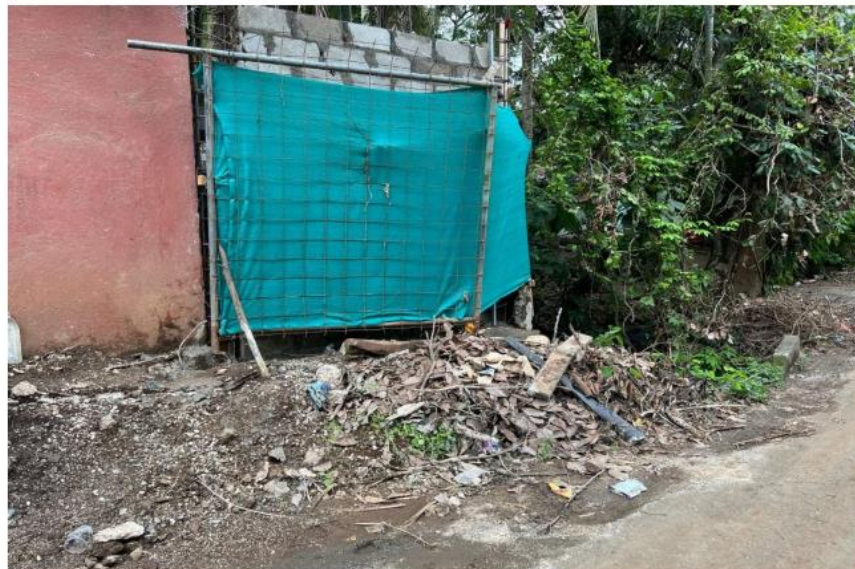
Fotografía 3. Tomada el 12 de octubre del 2023. Muestra atención a denuncia conjunta con Departamento de Inspecciones acerca de obras dentro de cauce de río. Sitio Villarreal. Distrito Tamarindo.
