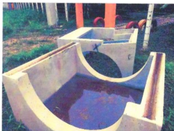
Caja de registro con presencia de agua estanca que puede generar criaderos del zancudo transmisor de Dengue. Comunidad de Guaral. 24 de junio del 2020.
