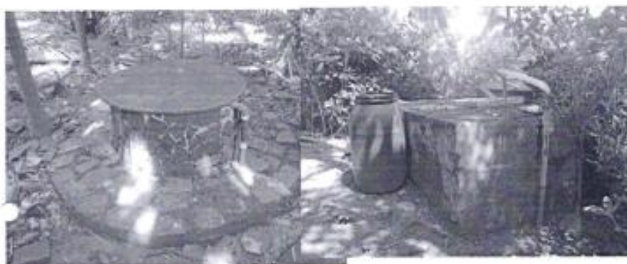
Fotografías del pozo y tanque actual para agua de uso en las facilidades
