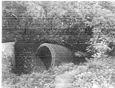
Foto N°3: Se observa problemas en alcantarillado pluvial, al costado Noreste de la plaza de la Rita.
