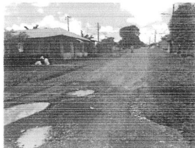
Foto N°1: Se observa calle frente a vivienda del señor Elizondo con problemas de erosión.
