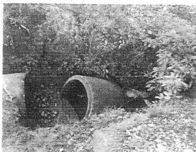
Foto N°2: Se observa problemas en alcantarillado pluvial, al costado Noreste de la plaza de la Rita.
