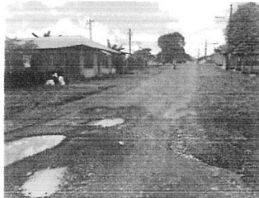
Foto N°2: Se observa calle frente a vivienda del señor Elizondo con problemas de erosión.
