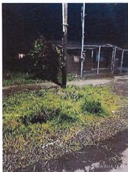
Foto 3: Alcantarilla abierta en horas de la noche.
