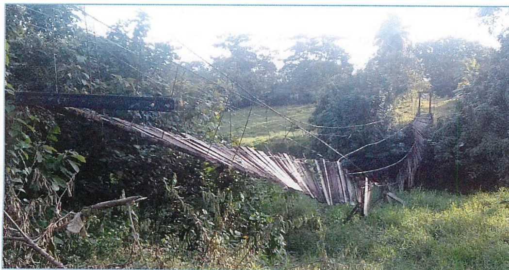
Figura N°2. Puente colgante inhabilitado
