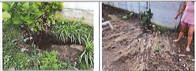
Figura 4. El mal estado de los drenajes aumenta la vulnerabilidad de inundación.
