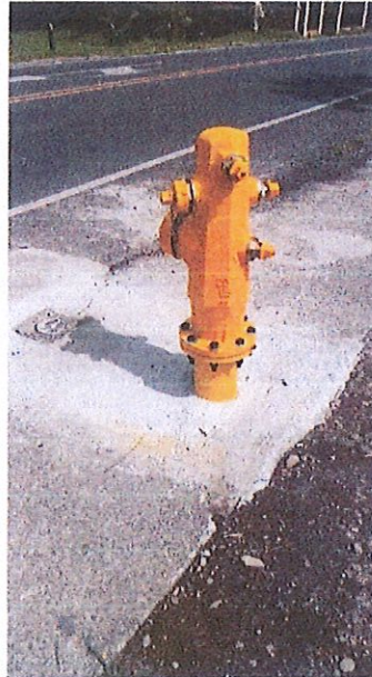
Figura 9. Hidrante colocado al costado este de la ruta 247, a inicios de la calle B del barrio Asemeba. Fuente propia.
