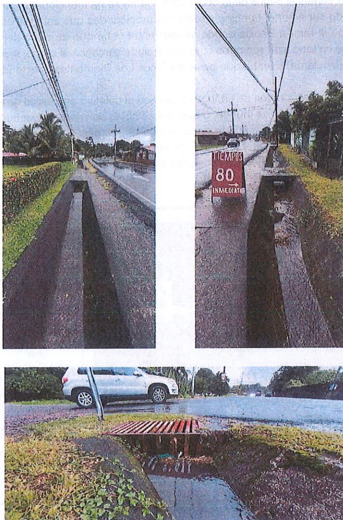
Figura 12. Caño en el costado oeste de la ruta 247, cercano al inicio de la calle C de Asemeba. Fuente propia.
