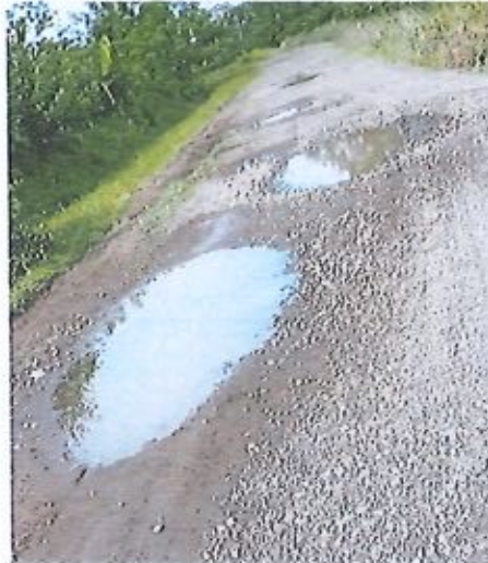
Fotografía 3. Hueco con acumulación de agua en el camino.
