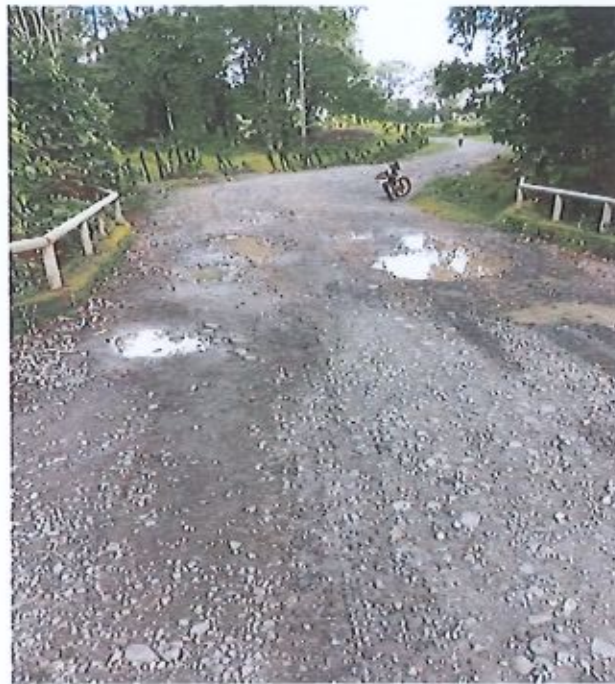
Fotografía 4. Cruce del camino con varios huecos y acumulación de agua.
