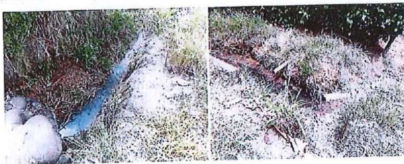
Fotografías 1 y 2. Aparente desfogue de aguas residuales en alcantarillado pluvial.
