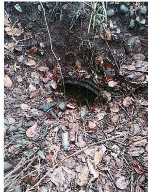
Foto N°3: Se observa alcantarilla colapsada por los supuestos trabajos realizados por el señor Enrique Zamora.
