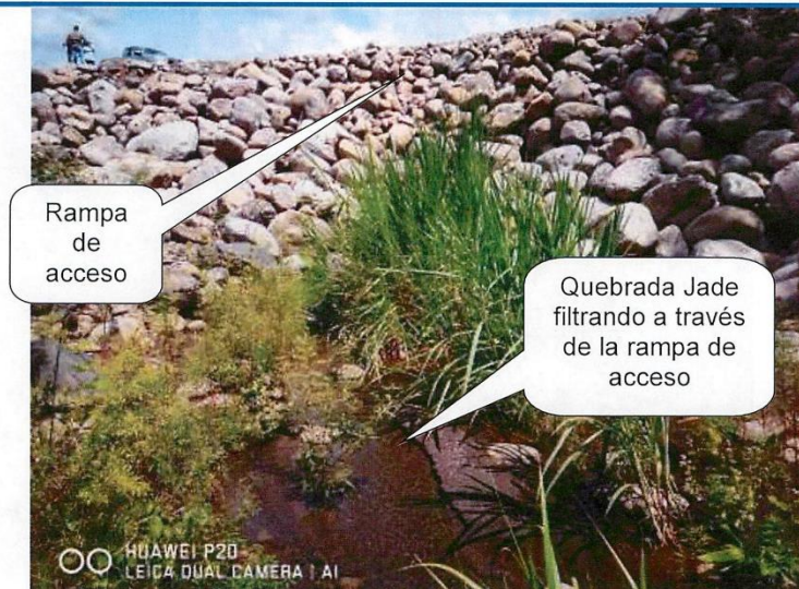
Imagen 2. Taponamiento de la quebrada Jade
