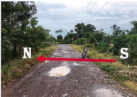
Foto N°1: Se observa la dirección del agua cuando hay escorrentía pluvial de Sur a Norte.
