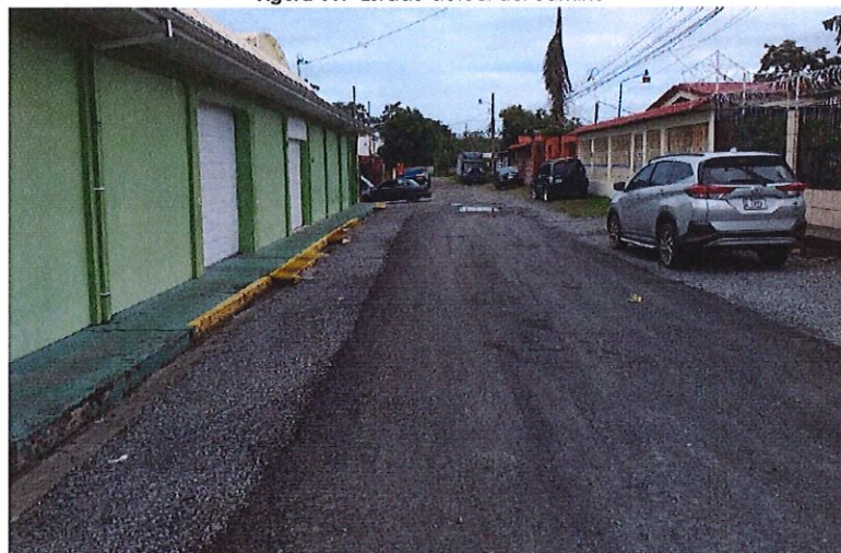
Figura 11.- Estado actual del camino
