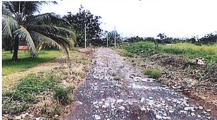
Figura 4.- Estado del acceso – Agosto 2018
