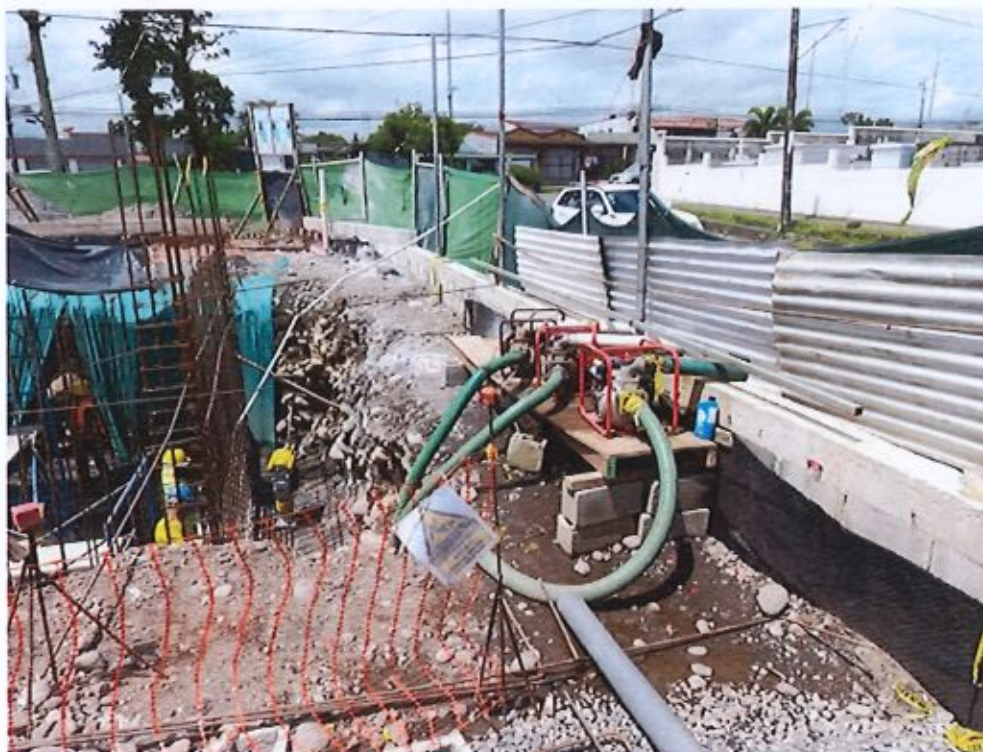
Imagen #5. Equipo de bombeo.
