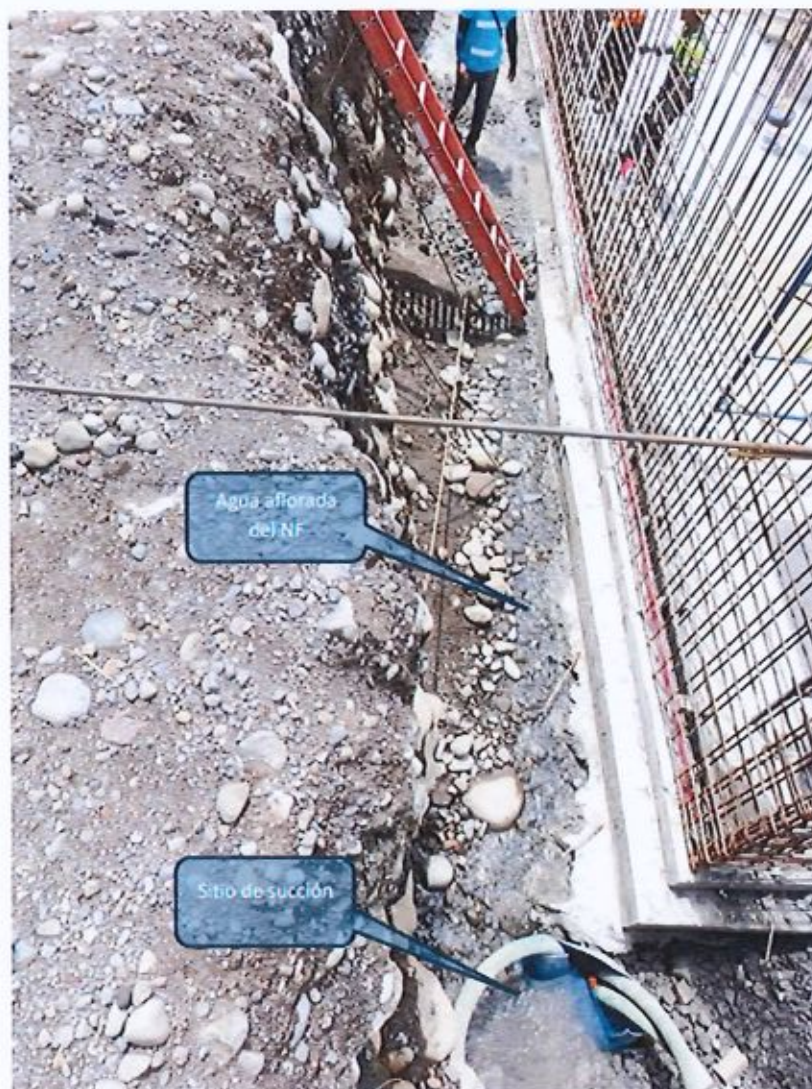
Imagen #4. Sitio de succión para extracción de agua del nivel freático.
