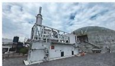
6.- Cogeneración con biometano para la producción de energía eléctrica limpia, estable y constante
