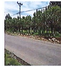
Fotografía N° 2: Se observa ausencia de cuneteo pluvial en la vía pública.
