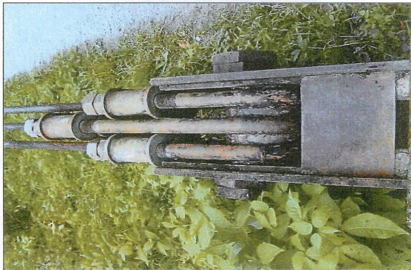
Figura 18. Estado de corrosión del anclaje
