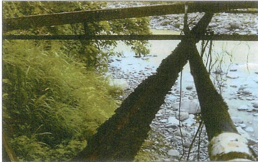
Figura 12. Estado de los diagonales del entrepiso
