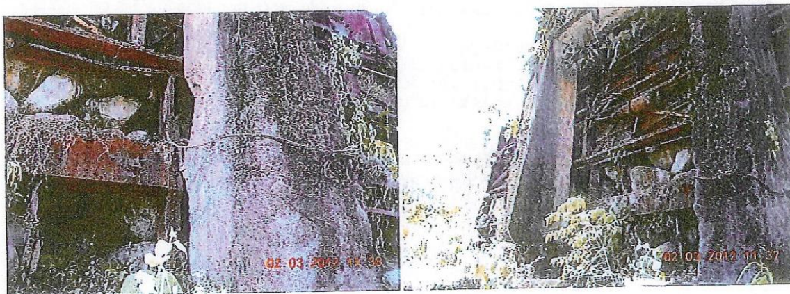
Figura 9: Condición de los marcos de concreto reforzado Fuente: Visita Inspección LanammeUCR 3-2-12
