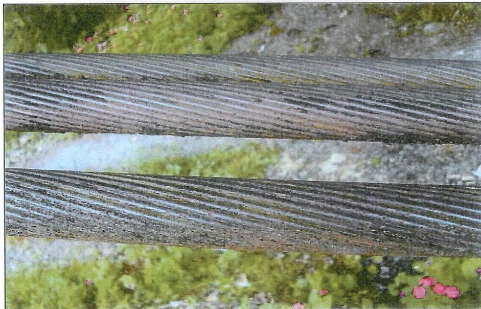
Figura 3. Estado de corrosión de los cables principales
