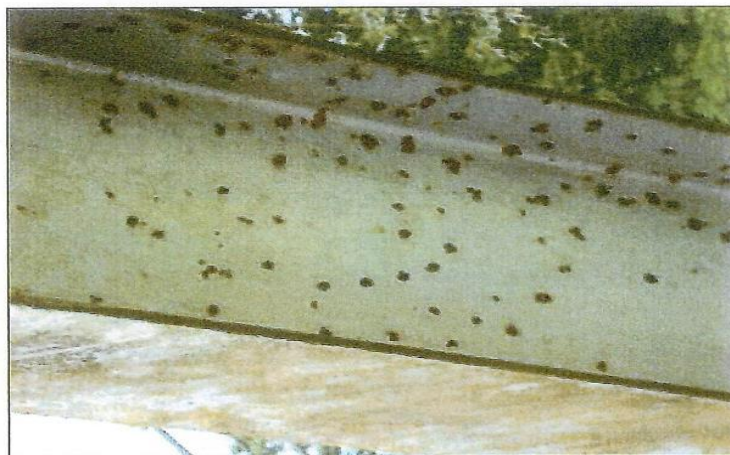
Figura 6. Aparición de lunares de corrosión en la viga de rigidez
