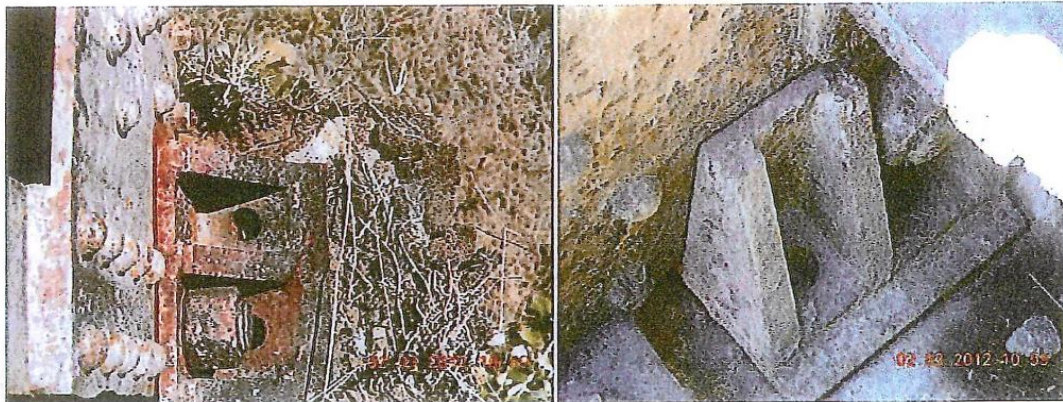
Figura 8: Fallas en los apoyos del puente Fuente: Visita Inspección LanammeUCR 3-2-12
