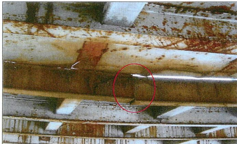
Figura 11. Viga longitudinal de entrepiso cortada
