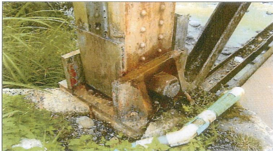
Figura 24. Tubería expuesta en la zona del acceso al puente
