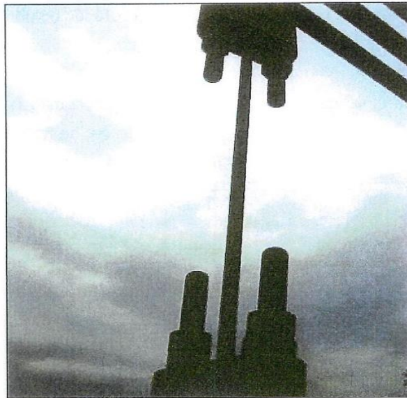
Figura 13. Estado de corrosión de las péndolas
