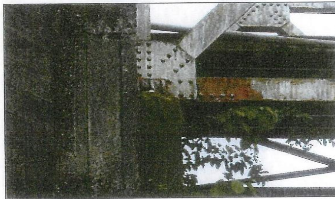
Figura 9. Estado del pedestal de apoyo de la viga de rigidez con el bastión
