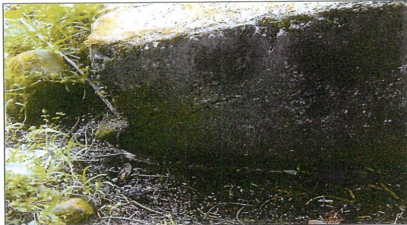
Figura 19. Fisuras en el concreto del bloque a reacción
