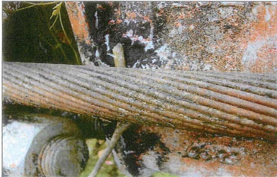
Figura 4. Vista del estado de corrosión en uno de los cables principales
