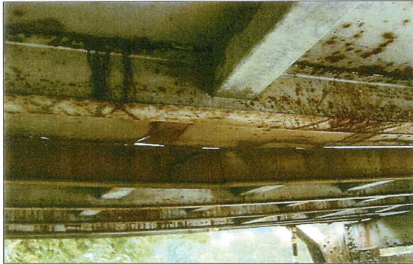
Figura 10. Estado del sistema de entrepiso
