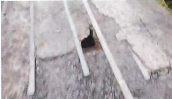
Anexo 2 daños en el estructura ferroviaria 15-04-2025 (foto 2)
