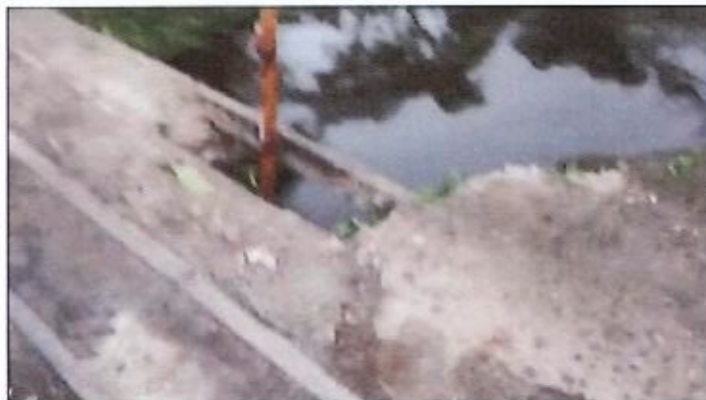
Anexo 3 daños en el estructura ferroviaria 15-04-2025 (foto 3)
