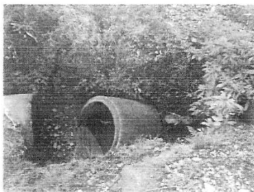
Foto N°2: Se observa problemas en alcantarillado pluvial, al costado Noreste de la plaza de la Rita.
