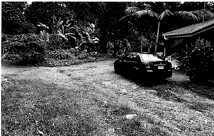
Fotografía 1.- Estado actual de la superficie de rodamiento (Continuidad)
