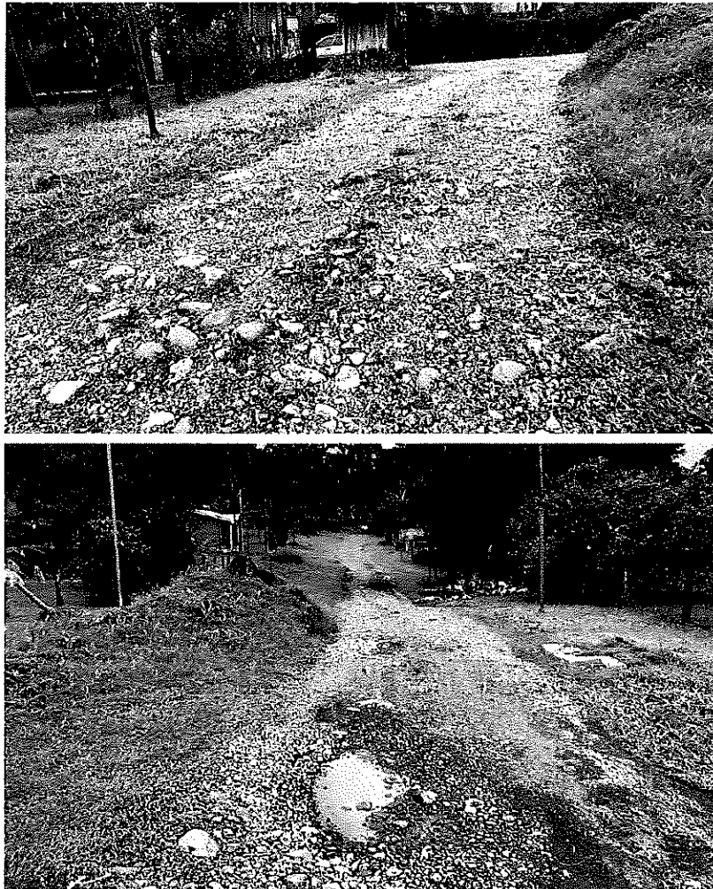
Fotografía 1.- Estado actual de la superficie de rodamiento
