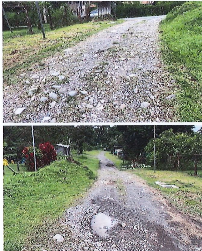
Fotografía 1.- Estado actual de la superficie de rodamiento
