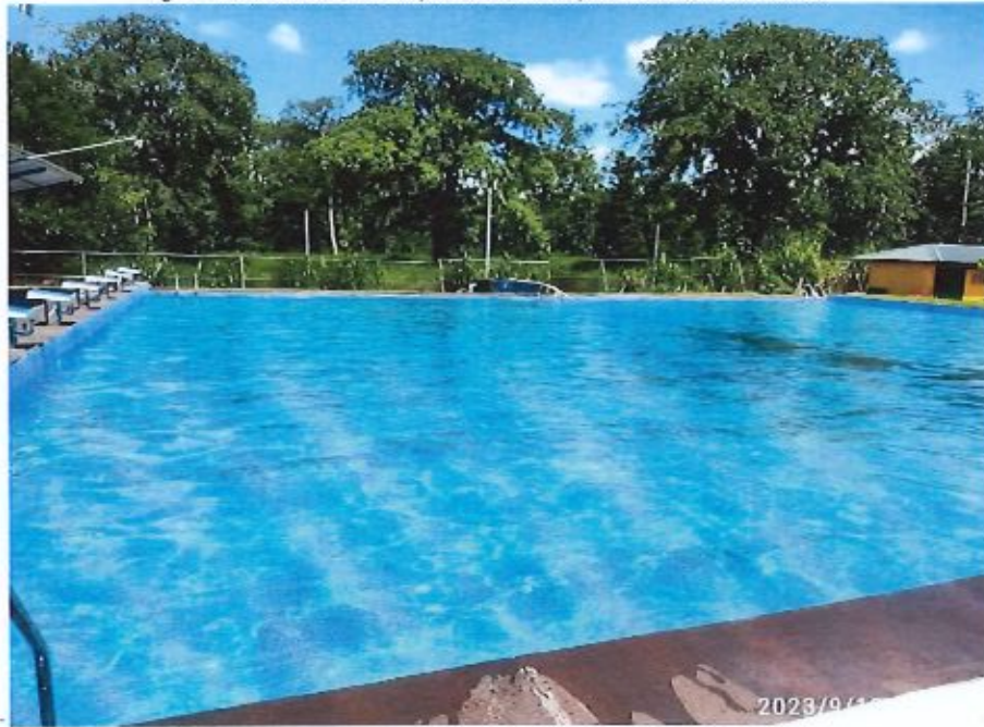
Figura 19.- Estado final de la piscina semi olímpica del Centro Acuático
