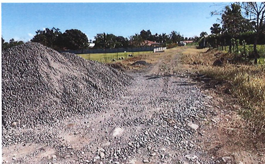
Fotografía 1.- Estado actual de la superficie de rodamiento
