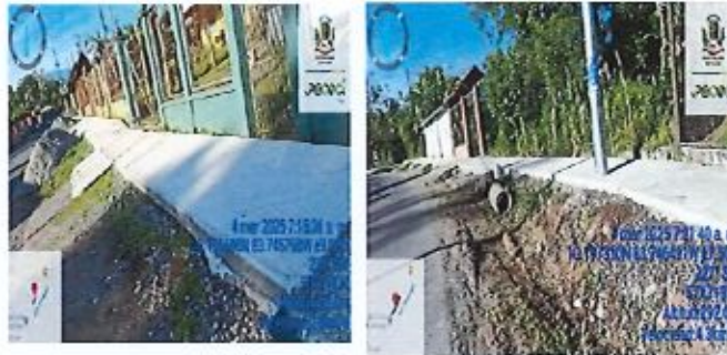
Fotos. Puente Chiriposito.
