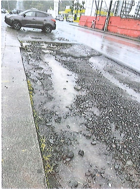
Foto 3. Vista general de la franja dañada a lo largo del cordón, con tránsito vehicular y peatonal.
