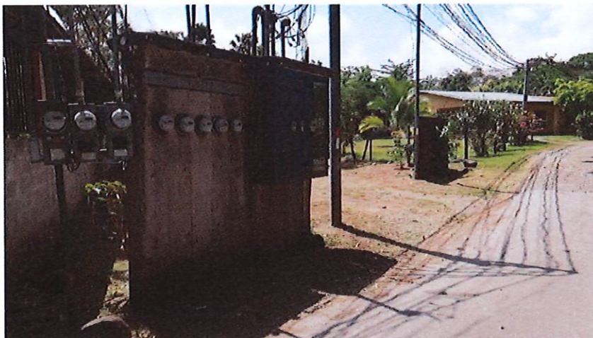
Medidores ICE para las viviendas existentes al inicio de la servidumbre agrícola.
