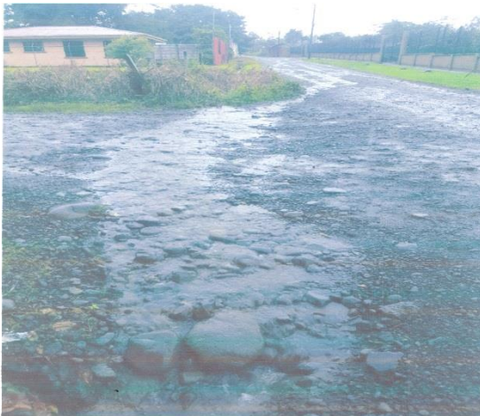
Esta es la zanja que se está formando por falta de alcantarillado. Se ocupan 10 alcantarillas.
