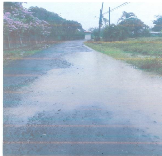
Esto es por la bloquera, al no tener alcantarillas no tiene salida y se estanca.
