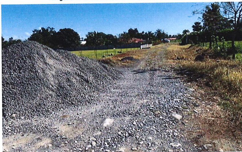
Fotografía 1.- Estado actual de la superficie de rodamiento
