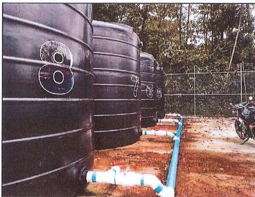
Figura 8. Tanques 5, 6, 7 y 8 del almacenamiento principal.
