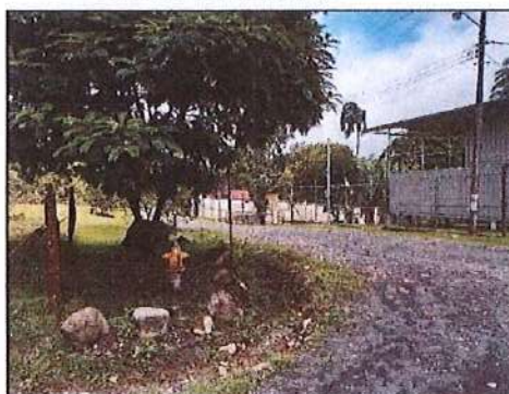
Figura 11. Hidrante ubicado en calle Gavilán.
