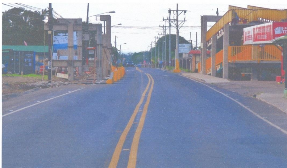
Vista sur - norte. Es evidente la curvatura de las líneas de separación de carriles.
