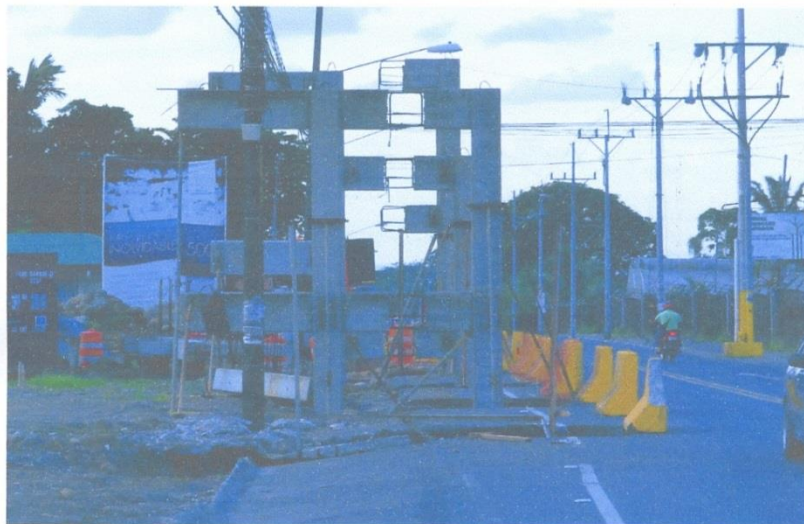
Estructura del costado oeste, invadiendo el carril de tránsito vehicular, además la barrera New Jersey, resulta un peligro inminente, en este momento.
