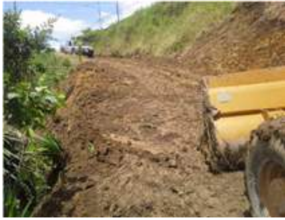
Remoción de derrumbes menores Ubicación: Pejibaye (varios sectores)
