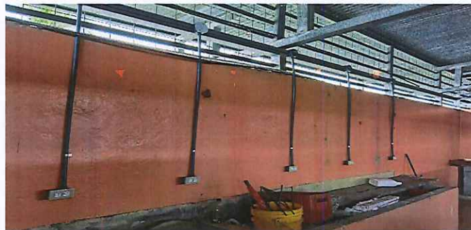
Figure 8 Parte instalación eléctrica
