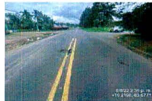
Fotografía N.º 6. Deterioro sobre ruta nacional 248
