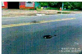
Fotografía N.º 5. Deterioro sobre ruta nacional 248
