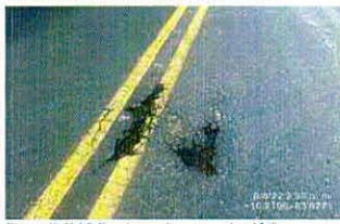
Fotografía N.º 7. Deterioro sobre ruta nacional 248
