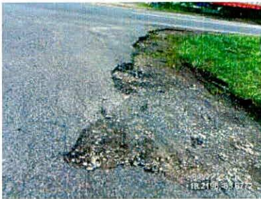
Fotografía N.º 4. Deterioros sobre ruta cantonal
