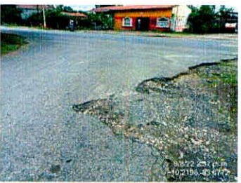
Fotografía N.º 2. Deterioros sobre ruta cantonal
