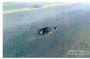
Fotografía N.º 8. Deterioro sobre ruta nacional 248
