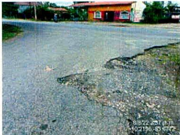
Fotografía N.º 2. Deterioros sobre ruta cantonal
