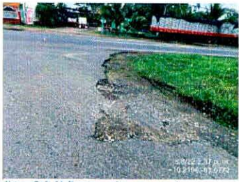
Fotografía N.º 1. Deterioros sobre ruta cantonal
