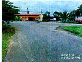
Fotografía N.º 3. Deterioro sobre ruta cantonal
