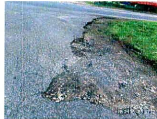
Fotografía N.º 4. Deterioro sobre ruta cantonal
