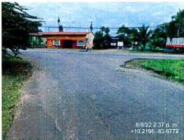
Fotografía N.º 3. Deterioros sobre ruta cantonal
