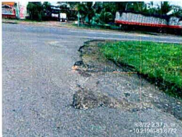
Fotografía N.º 1. Deterioros sobre ruta cantonal
