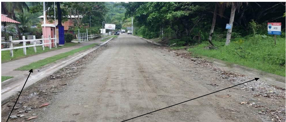
(Vista general de la calle desde la playa hacia la calle principal. En primer término parte de los 110 ml de calle con lastre existente el cual se encuentra deteriorado al unirse con el cordón y caño por efecto de la escorrentía pluvial al colapsar la tubería que se colocó. A la izquierda parte de los 173 ml de acera y cordón y caño construidos en el 2010 y a la derecha parte de los 180 ml de cordón y caño construidos en el 2015 hasta la calle principal)
