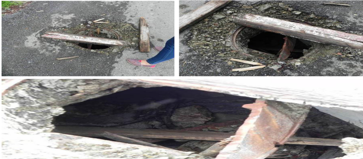
Vistas del pozo de registro pluvial totalmente colapsado por piedras, madera y otros materiales. Se le colocó el flangerb con tapa pero esta está quebrada. Se hace necesario una revisión de las tuberías desde los tragantes al pozo y de este hacia el otro pozo, por estar llenas de escombros y materiales como arena y piedra que impide su operación.
