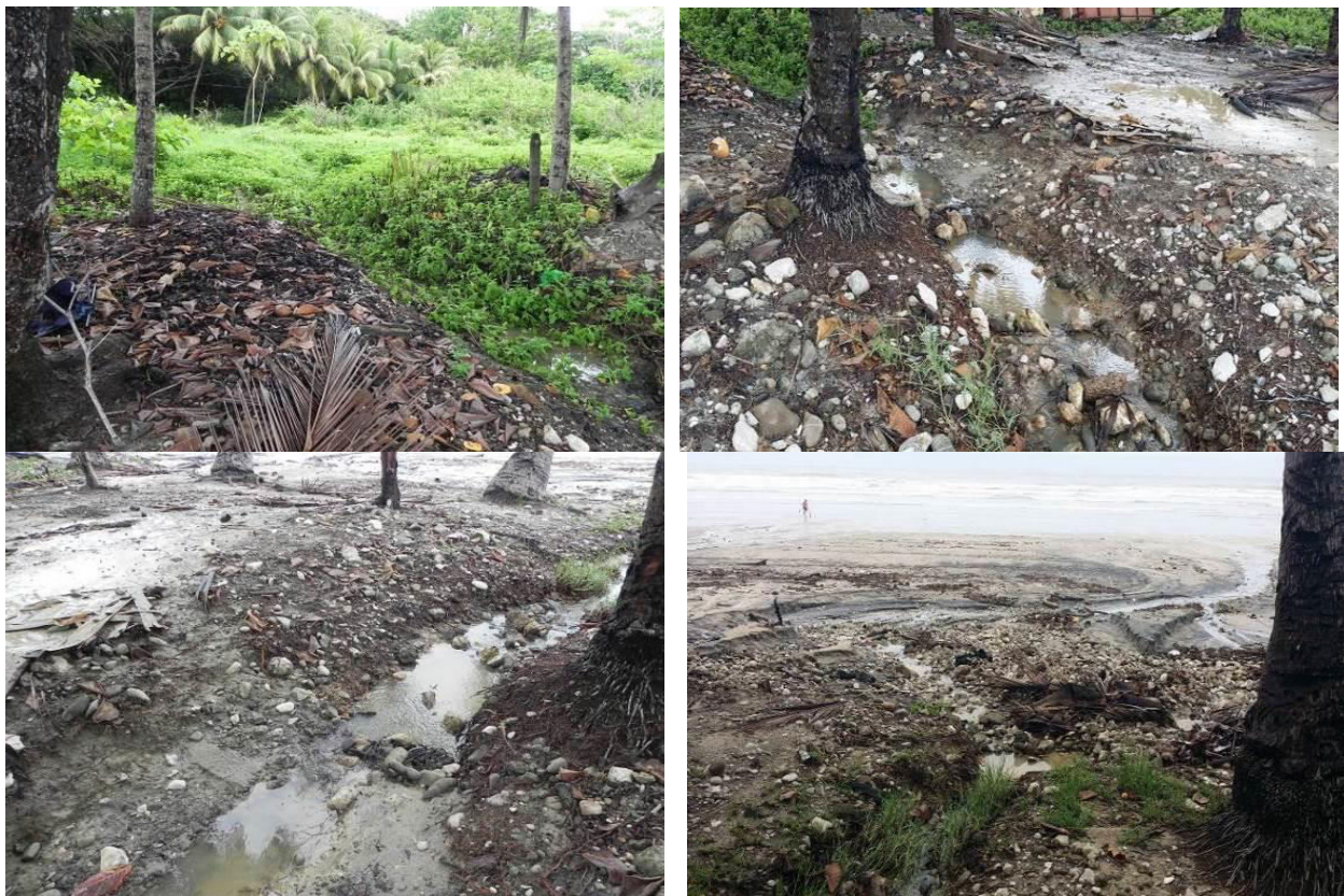
Vistas del cause permanente de aguas pluviales que salen de la concesión n.º 1 entre mojones 50 y 51 que muestra el evidente deterioro en la zona publica y la playa.
